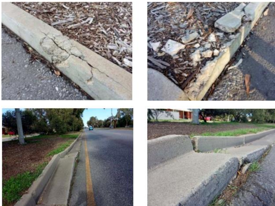
Зураг 7. Замын хашлага дээшээ шилжсэн байдал.
